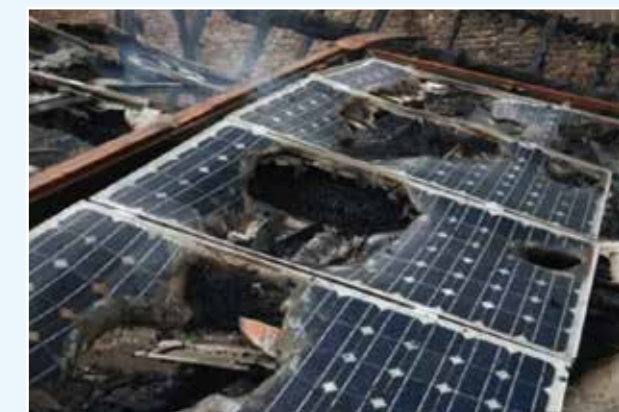
Požár fotovoltaických panelů – technická závada na panelech
