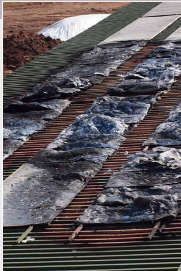
Požár fotovoltaických panelů na ploché střeše skladovacího objektu
