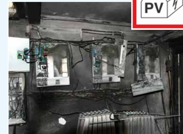
Požár střídače a baterie FVE v rodinném domě
