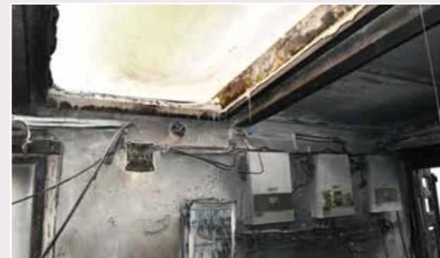
Požár střídačů a rozvaděčů v rodinném domě
