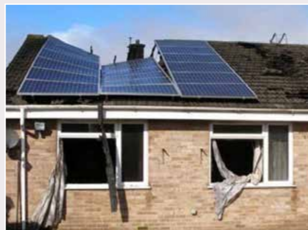
Požár fotovoltaických panelů – technická závada na propojení
